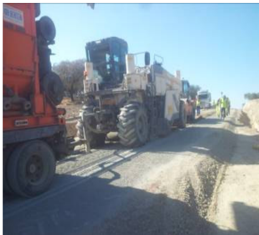
Ejecución del suelocemento in situ en la carretera H212 Encinasola-límite provincia Badajoz.
