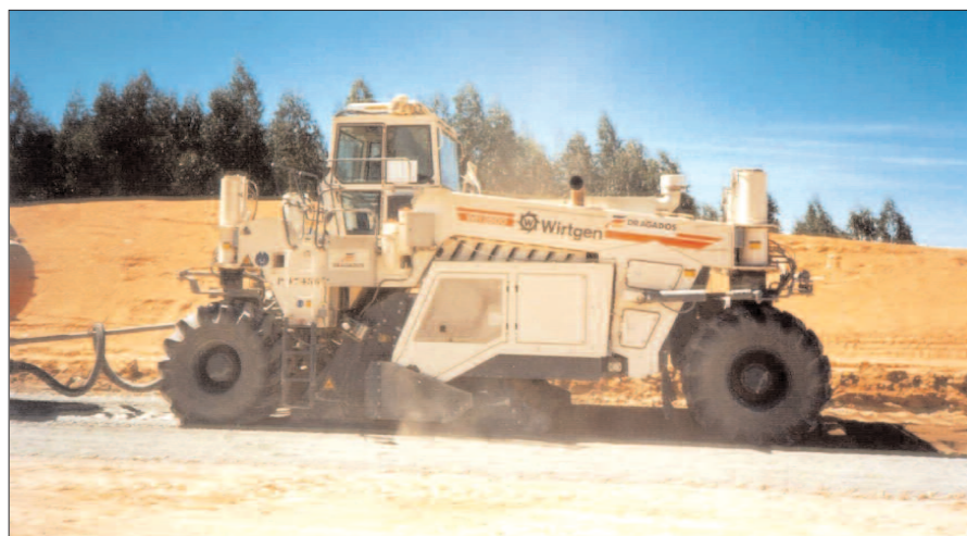
Figura 5.19 Máquina con el rotor en posición central, bajo el motor
