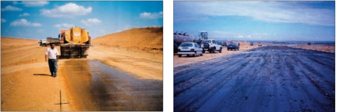
Figura 6.17 Curado de la capa estabilizada con agua y con riego de emulsión
