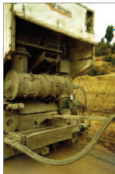
Figura 5.16 Detalle de los elementos de dosificación, mezcla y bombeo
