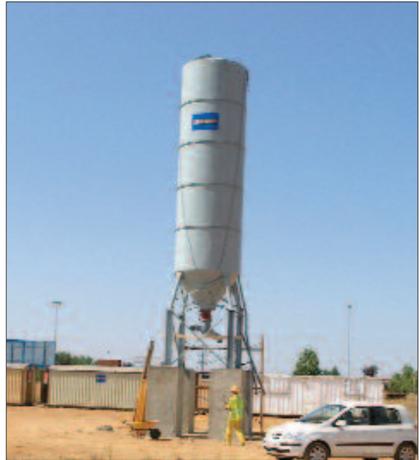
Figura 5.1 Silo vertical fijo
