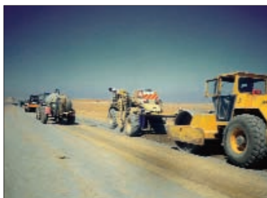
Figura 6.13 Estabilización por calles o bandas cortas con un único equipo, y en bandas largas con dos equipos
