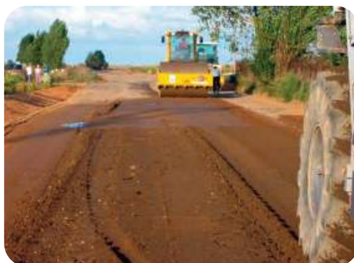
Figura 8.42.- Excesiva humedad en el material reciclado
