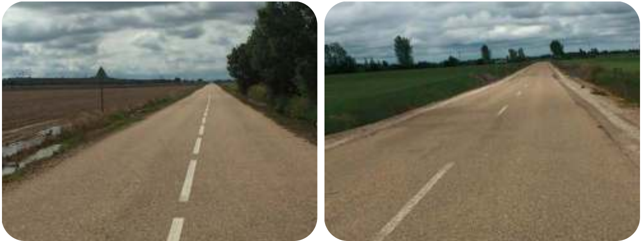
Figuras 8.36 y 8.37.- Carreteras en Palencia con más de 18 años de vida una vez recicladas sin reforzar, a pesar de que el agua se acumula en algunas márgenes.
