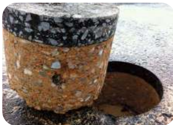
Figura 8.51.- Extracción de un ancho testigo en una carretera: 10 cm de mezcla bituminosa + 25 cm de material reciclado
