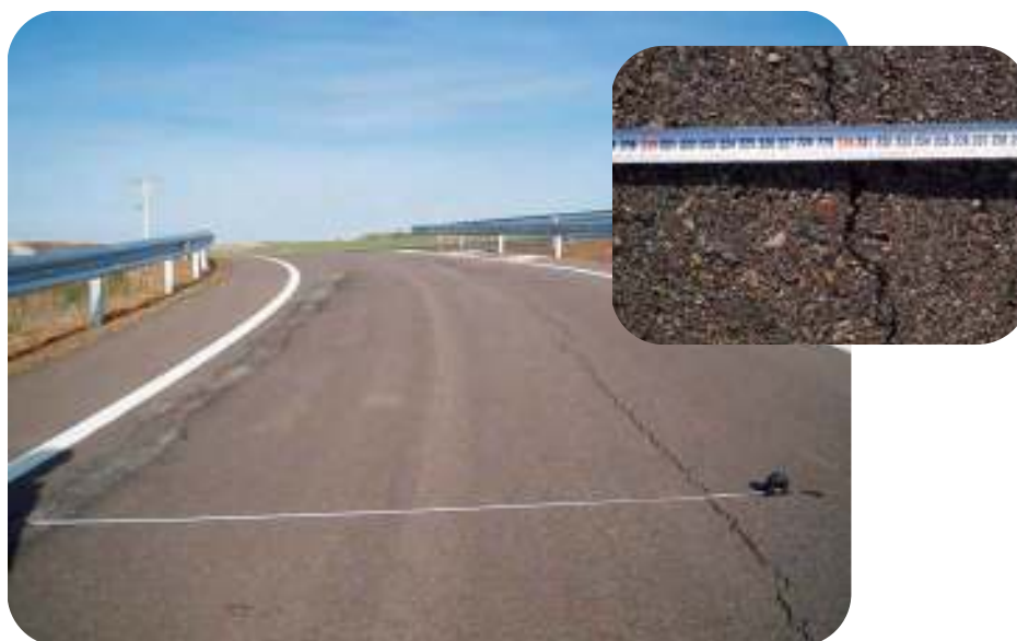
Figura 8.40.- Problemas de reflexión de las fisuras cada \pm 2,40 m en una calzada carente de solape de las bandas de reciclado
