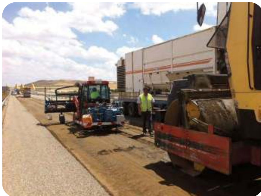
Figura 10.6.- Algunos de los equipos auxiliares en un reciclado
