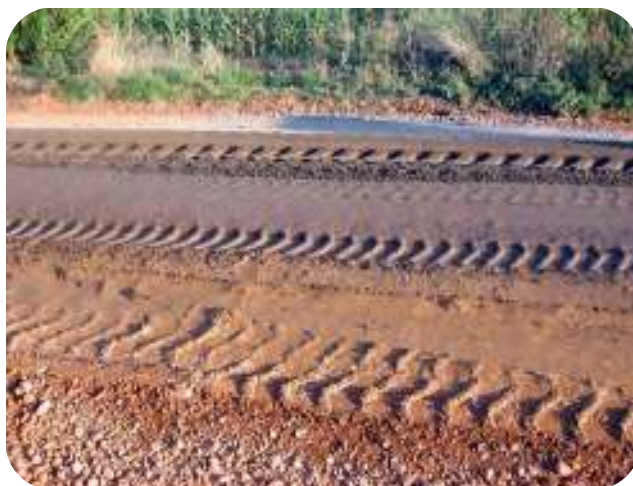
Figura 8.49.- Material con bandas muy heterogéneas en el reciclado de una carretera
