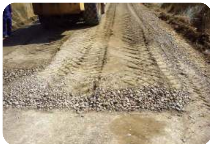
Figura 8.41.- Segregación y nidos de áridos en un arranque
